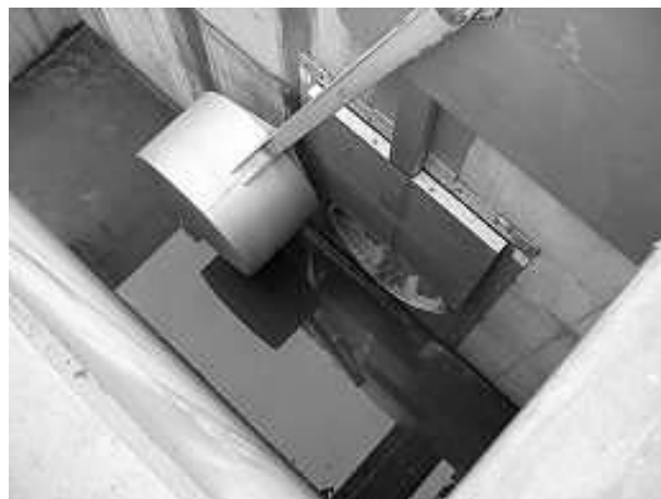
写真-7 底部洪水吐きの自動開閉ゲート
