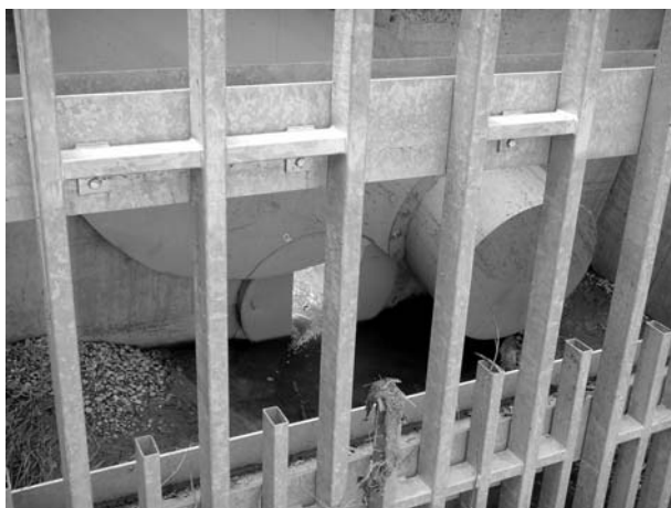
写真-5 底部洪水吐きの自動開閉ゲート （上流側より，スクリーンの中）
