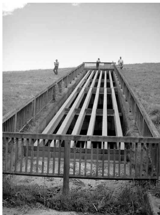
写真ー 16 底部洪水吐き上部の開口部とスクリーン
