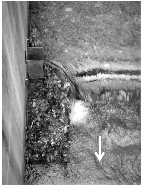
写真－19 底部洪水吐き側壁沿いに設置された蛇かご
