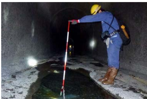
旭ダムのトンネル摩耗
