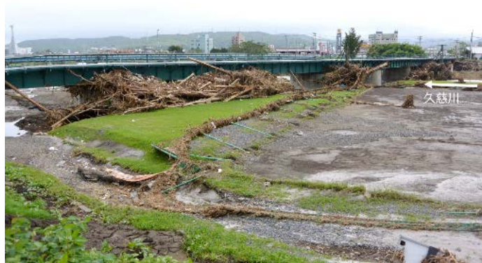
写真2 久慈川の JR 八戸線橋梁に捕捉された流木。
