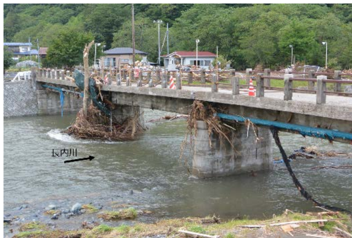
写真3 長内川の滝橋地点における流木捕捉の痕跡と氾濫被害の状況。橋の欄干が破損し、共架されている上水道管路の破損により断水も生じたとのこと。
