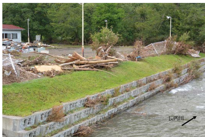
写真4 長内川の滝橋周辺における氾濫痕跡。
