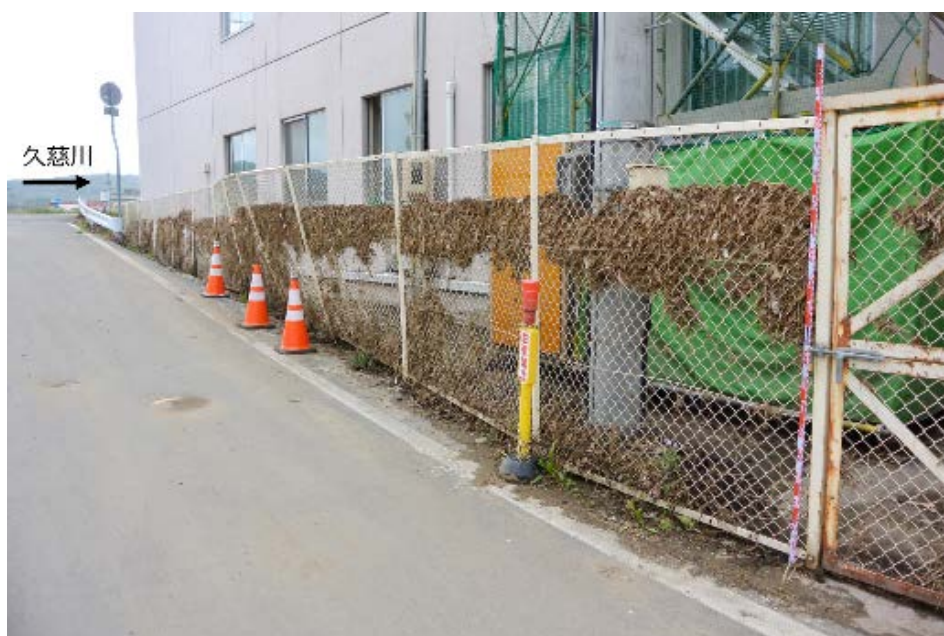
写真1 久慈市中心部における浸水痕跡の状況（久慈川右岸）。 氾濫水によって流された草がフェンスに付着している。
