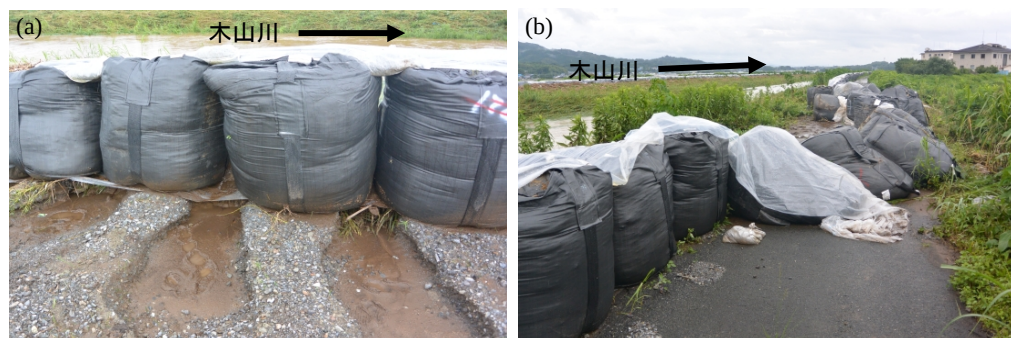
写真-6: 木山川堤防上部の大型土嚢の状況。(a) シート下部からの漏水、(b) 損壊状況。6 月 21 日撮影。
